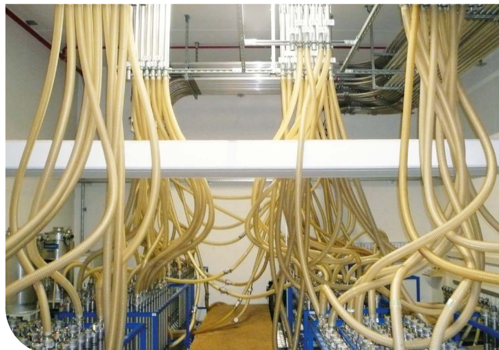
Verteilstation (Schlauchbahnhof), Weiterleitung des Rohstoffes zur Granulattrocknung
